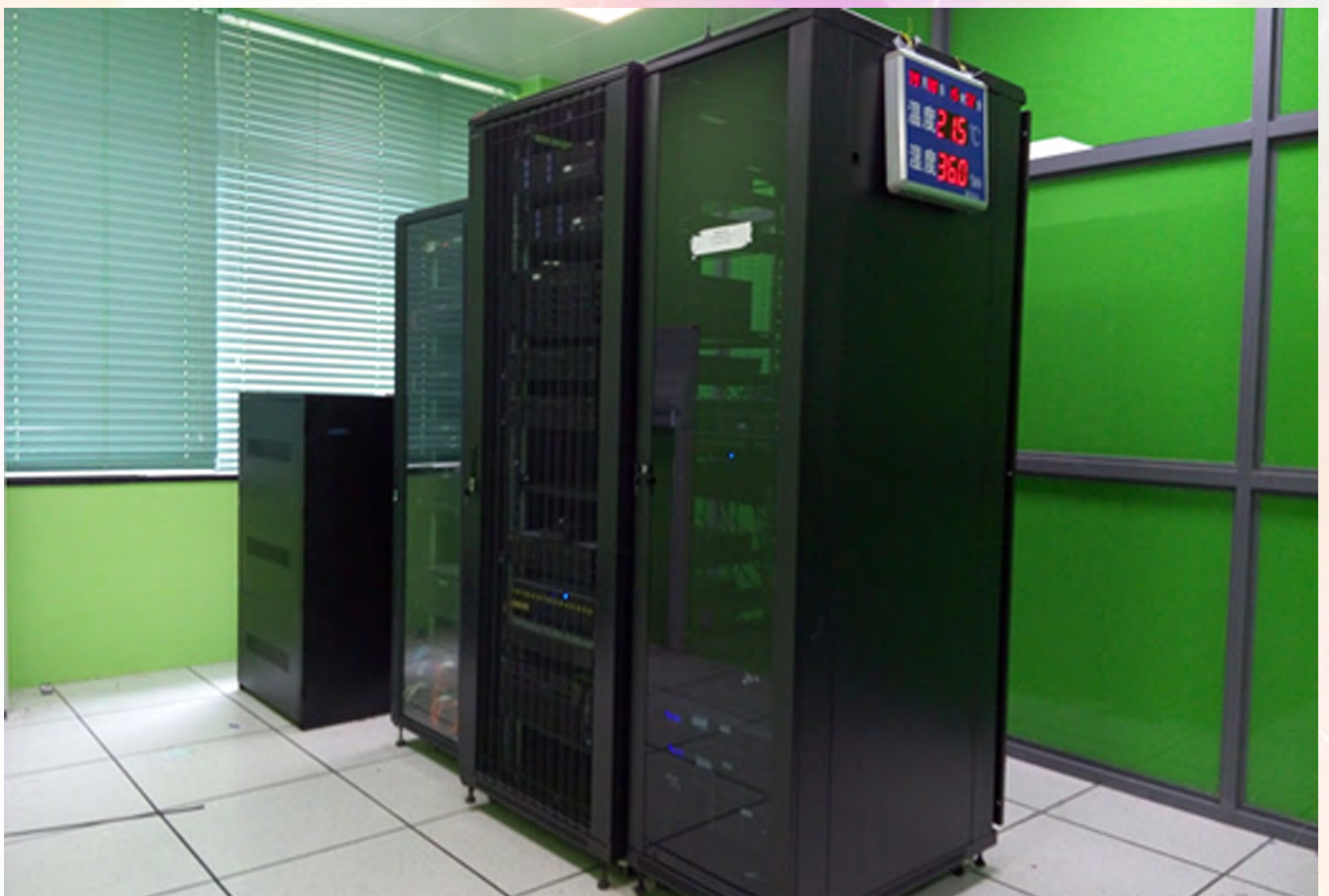
教学硬件设备机房
